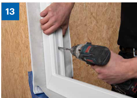
13 > Ausgangssituation: Eingebauter Fensterrahmen mit vorgefertigter Klebeband-schürze. Nach den örtlichen Gegebenheiten bzw. den Angaben des Planers entscheiden, ob mit der Verklebung auf der Innen- oder Aussenseite begonnen wird (Witterung und Baufortschritt berücksichtigen).
