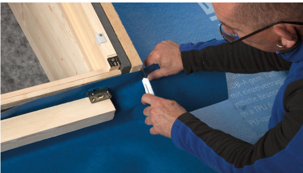
5. Vertikalschnitt entlang der Außenkante des Fensterrahmens/Dämmrahmens bis zur Höhe der Unterkante der Traglatte.
