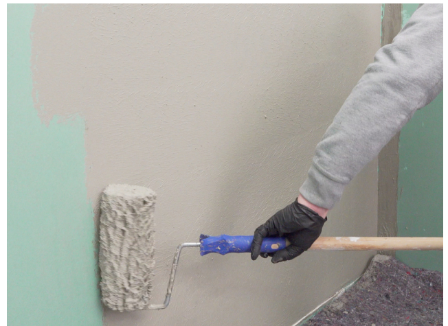
Für ein gleichmäßig deckendes Ergebnis Sopro Fixier- & DichtKleber oder Sopro DichtSchlämme Flex RS im Kreuzgang auftragen.
